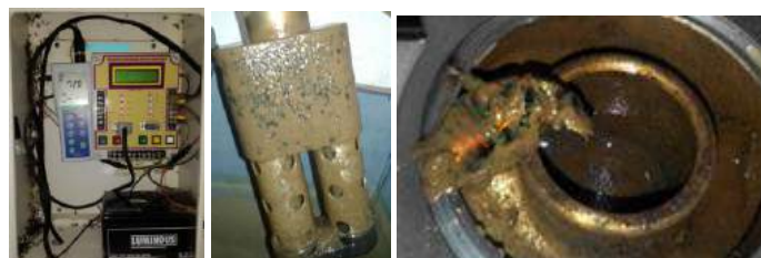
Gambar 4. Sarang Semut Pada Box Panel RTU dan Sarang Lebah Pada Pipa Bak Penampungan
